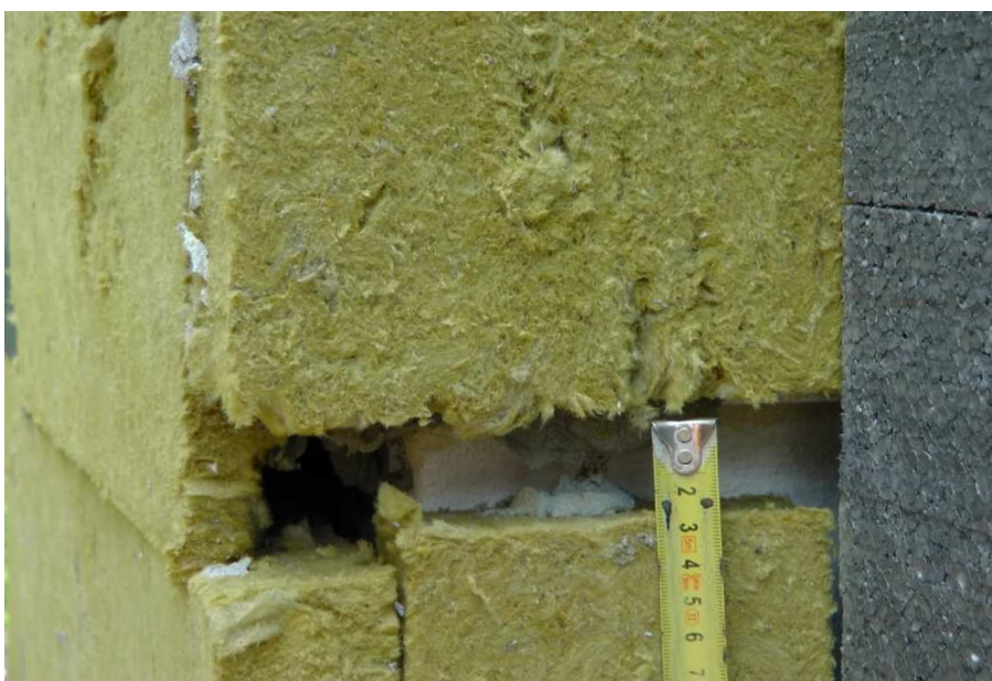
Obr.č.5 Nekvalitně provedená montáž tepelné izolace [1]
