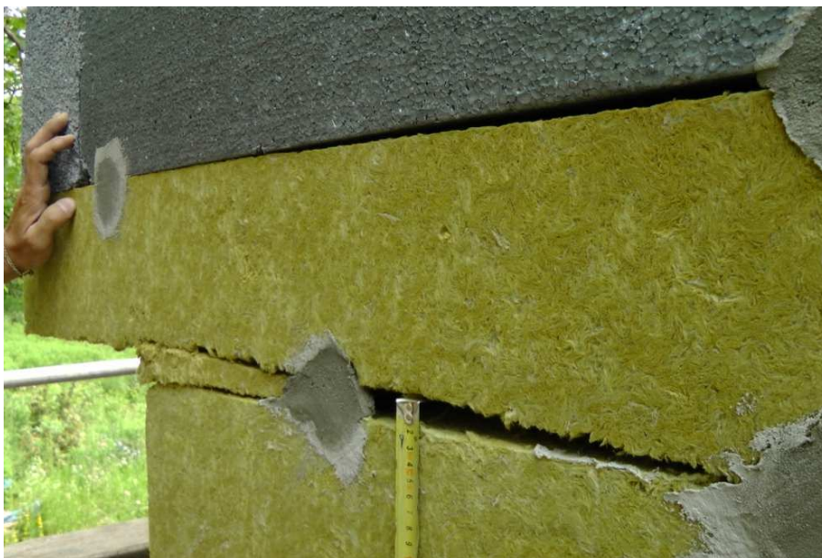
Obr.č.4 Nekvalitně provedená montáž tepelné izolace [1]
