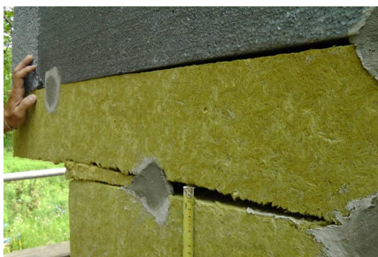
Obr.č.5 Nekvalitně provedená montáž tepelné izolace
