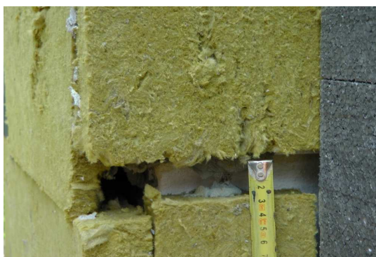
Obr.č.6 Nekvalitně provedená montáž tepelné izolace
